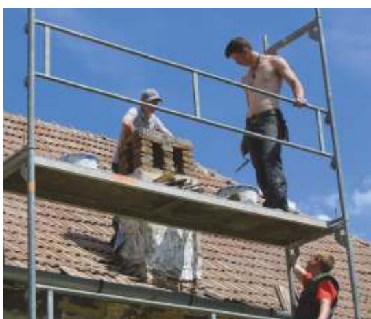
Der Kamin des Gemeindesaals ist undicht – Feuchtigkeit breitet sich über die undichte Stelle am Dachanschluss in den Innenraum aus
