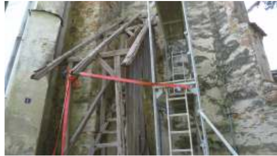
Der baufällige, nicht mehr nutzbare, seitliche Treppenaufgang an der Kirche in Martinsdorf
