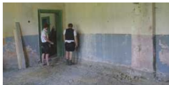
Der Fußboden im Klassenzimmer der Grundschule in Martinsdorf
